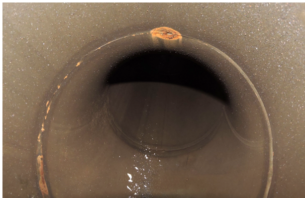
Obr. 1. Korozní napadení potrubí na upravovanou vodu z korozivzdorné oceli třídy 304 (1.4301) v oblasti svarového spoje; povrch potrubí je pokryt depozity na bázi manganu a železa (tmavé) a vodního kamene (světlé částice)
